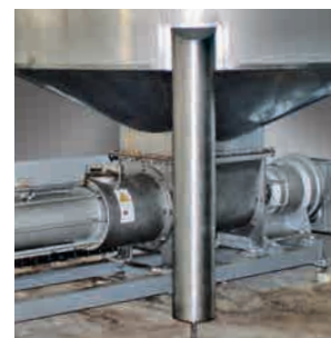
Процесс подачи в винтовой насос KL100RL120-8 V4A
