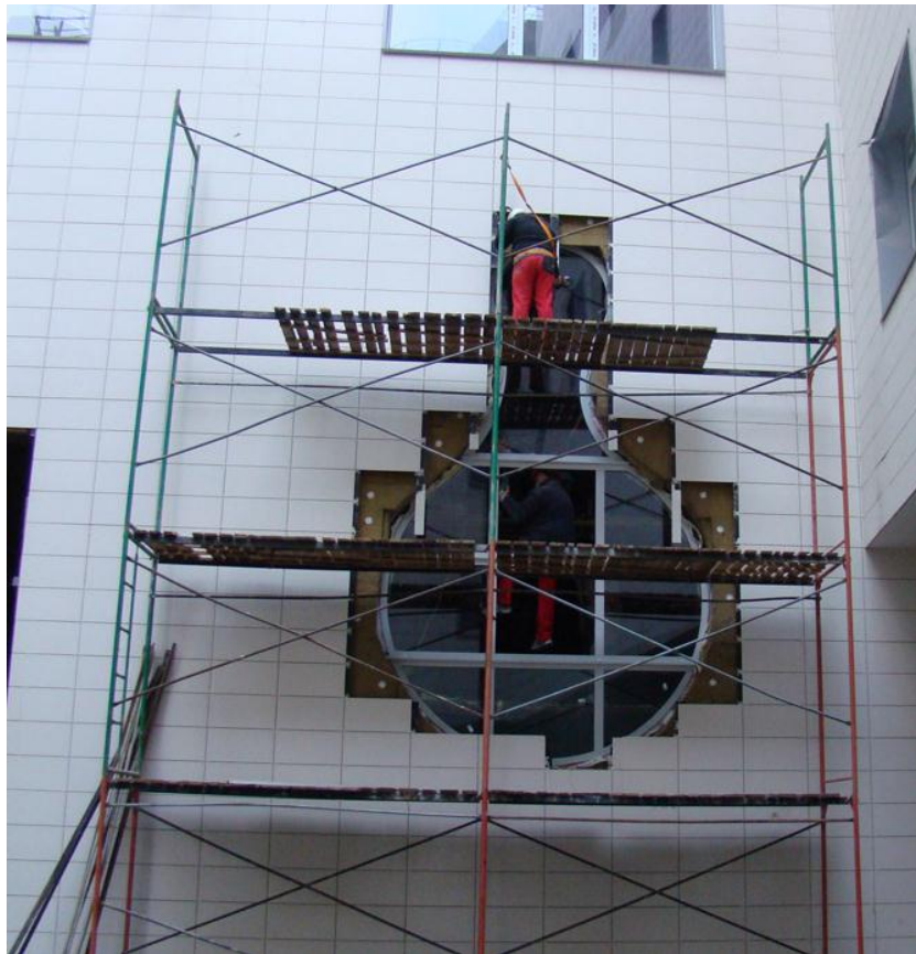
Рис 5.5.1 Організація робочого місця: а-схема організації робочого місця; б- виконання робіт по установці вікна
