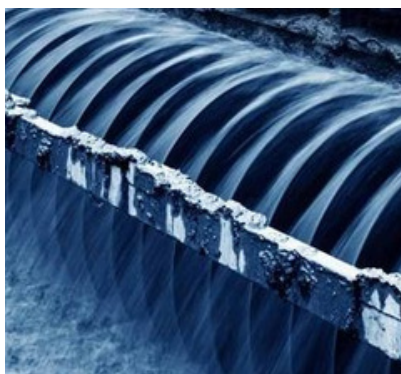
ОЧИСТКА СТІЧНИХ ВОД
