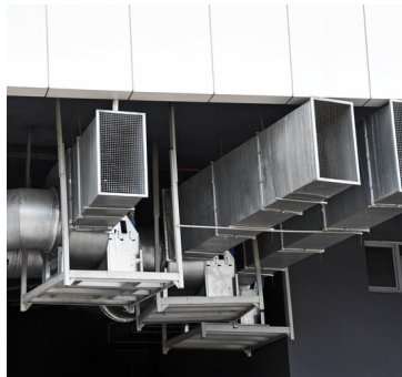
ВЕНТИЛЯЦІЯ ТА ОБЛАДНАННЯ
