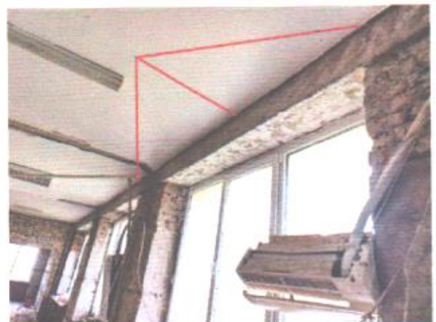
Фото 23 Зміщення плит перекриття із зовнішньої стіни
