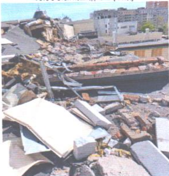
Фото 4 Руйнування надбудови на покрівлі будівлі
