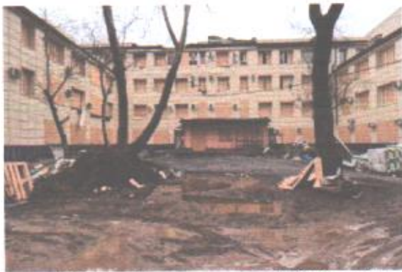
Фото 1 Загальний вигляд пошкоджень будівлі з боку дворового простору
