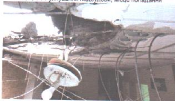
Фото 15 Руїнування плити перекриття
