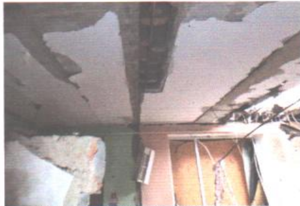
Фото 18 Випадіння розчину зі швів між плитами
