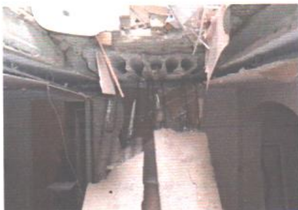
Фото 20 Руйнування плити перекриття, обвалення частини конструкції
