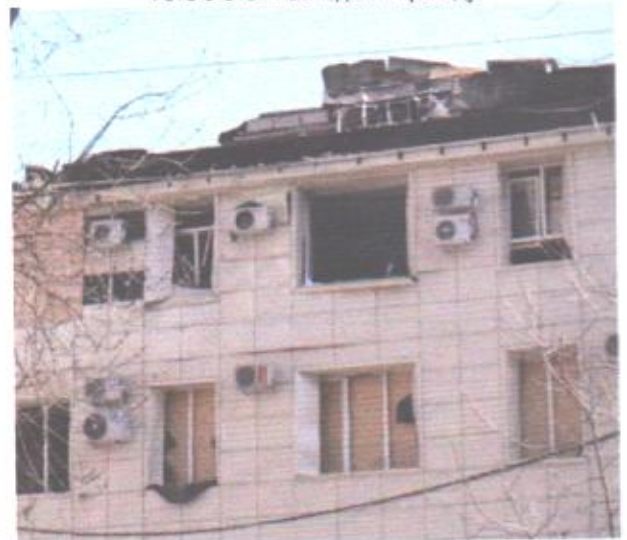
Фото 7 Місце попадання дрону в дах будівлі
