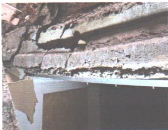
Фото 19 Руйнування плити перекриття 3 поверху в осях 12-13/В-Ж
