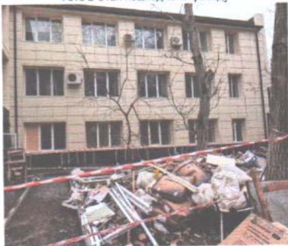
Фото 3 Стан пошкоджень фасаду
