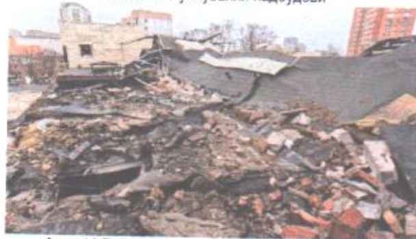
Фото 14 Руїнування надбудови, місце попадання
