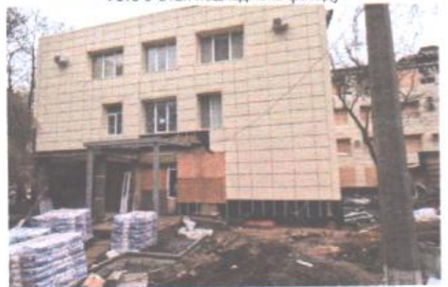
Фото 6 Стан пошкоджень фасаду
