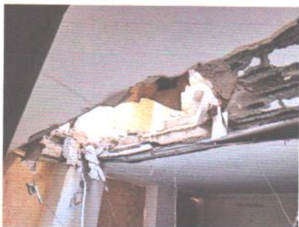
Фото 32 Стан руйнування плит перекрытия між 3 і 4 поверхами
