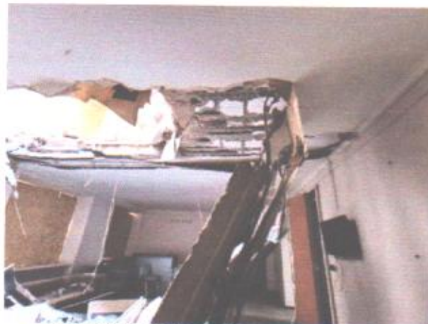
Фото 33 Обваления части плиты перекрытия
