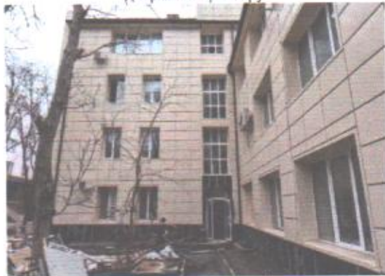
Фото 2 Стан пошкоджень фасаду
