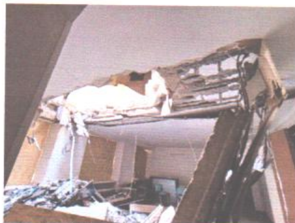
Фото 34 Обваления части плиты перекрытия
