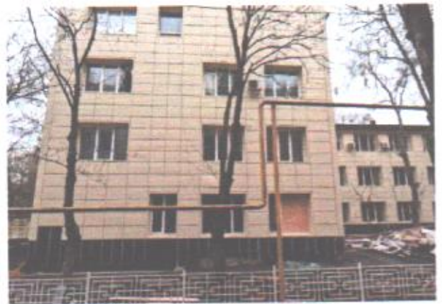
Фото 5 Стан пошкоджень фасаду
