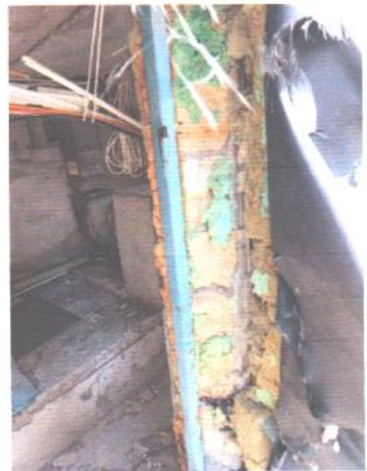
Фото 22 Пошкодження стіни надбудови
