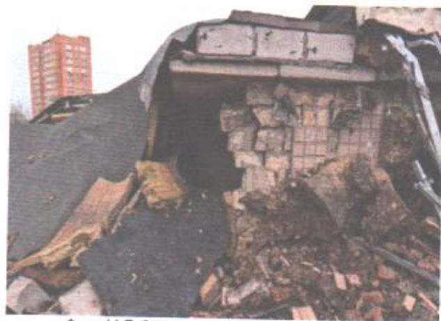
Фото 11 Руїнування конструкцій надбудови
