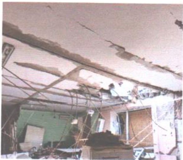
Фото 30 Прогини в плитах перекрытия
