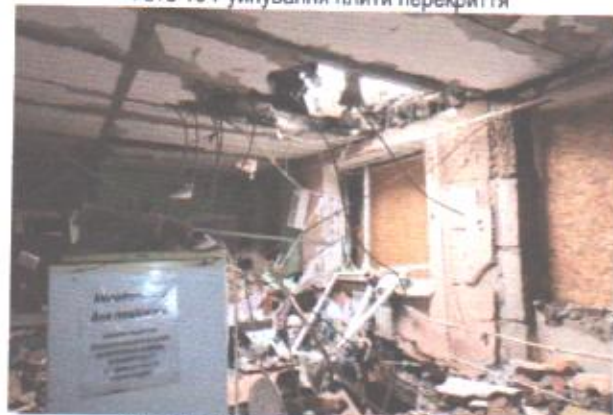
Фото 16 Руїнування плити перекриття
