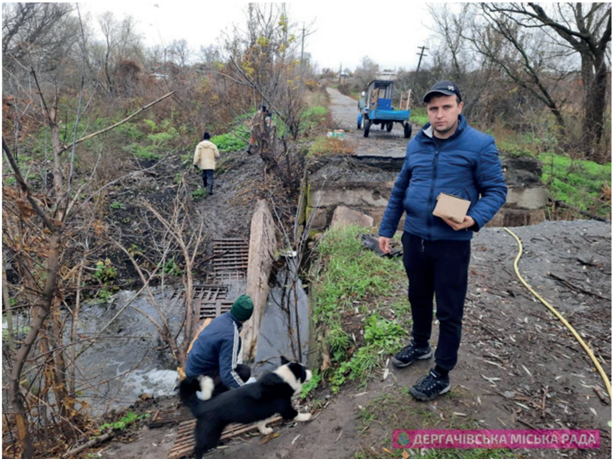
Фото 5. Зруйнований міст у снт Прудянка
