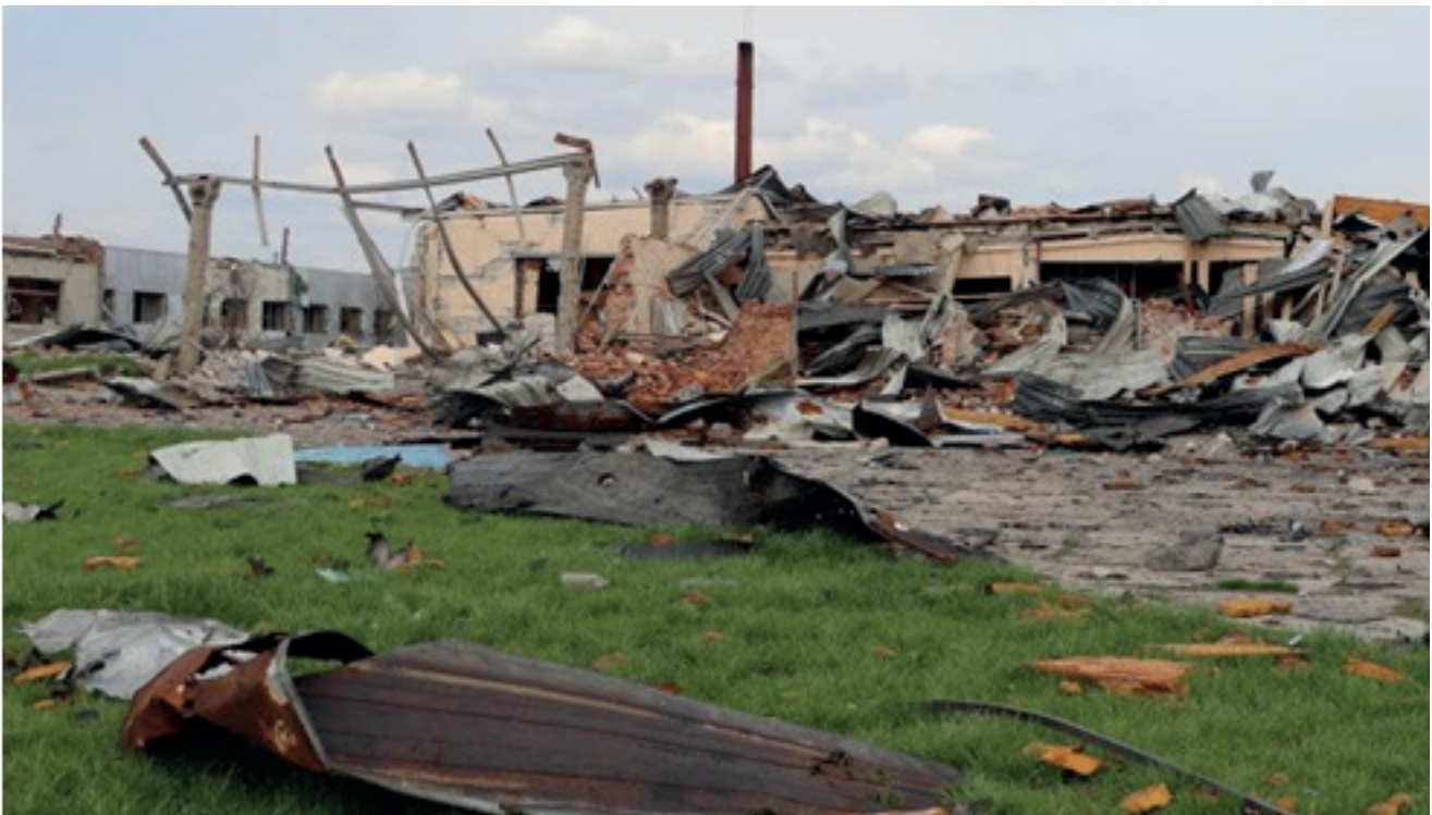
Фото 6. Зруйновані будівлі компанії «Папа Карло»
