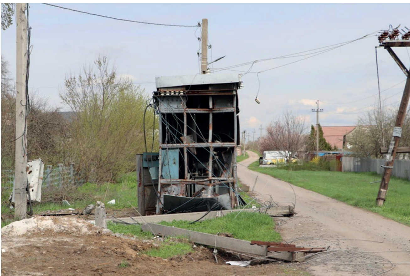
Фото 4. Зруйнована трансформаторна підстанція у місті Дергачі.
