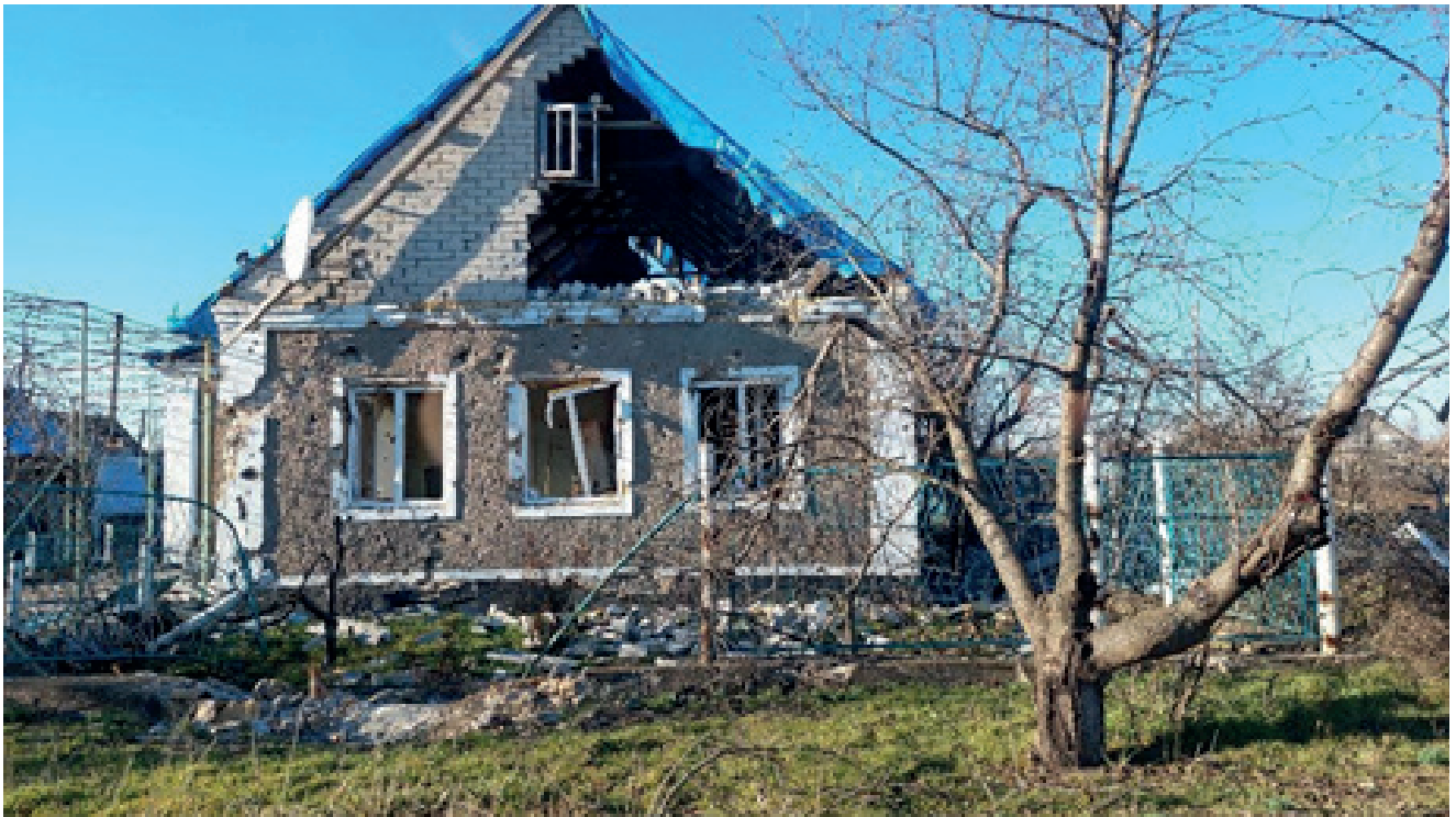
Фото 1. Руйнації приватного житлового фонду с. Осокорівка. Березень 2023 р.
