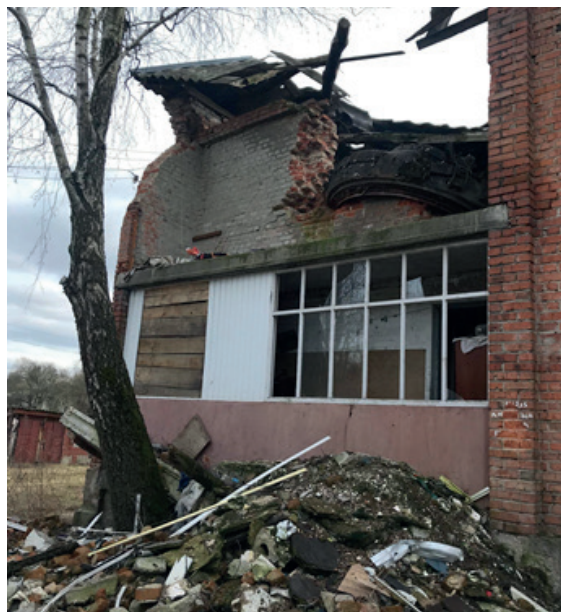
Фото 4. Частина будівлі багатоквартирного будинку в с. Дроздівка, зруйнована баштою танка
