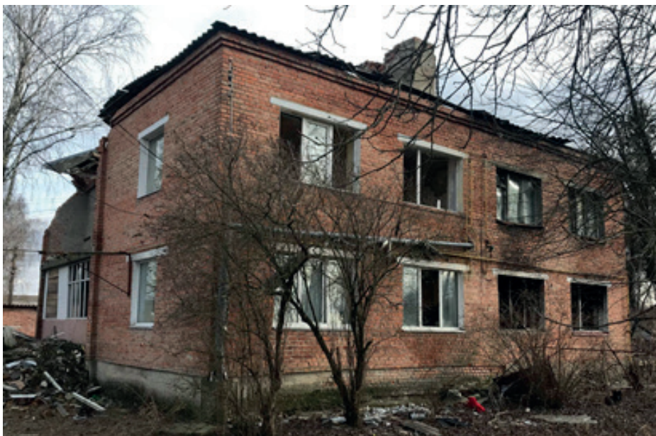
Фото 3. Будівля зруйнованого багатоквартирного будинку в с. Дроздівка
