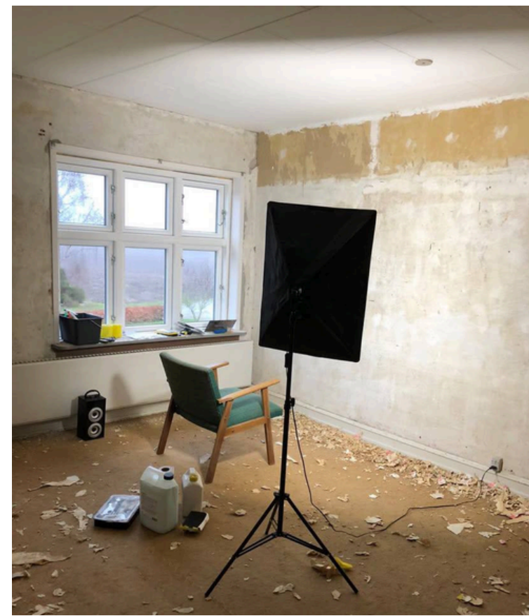
фото зі сторони входу (стіни, підлога, стеля, електрика будуть перероблюватись)
