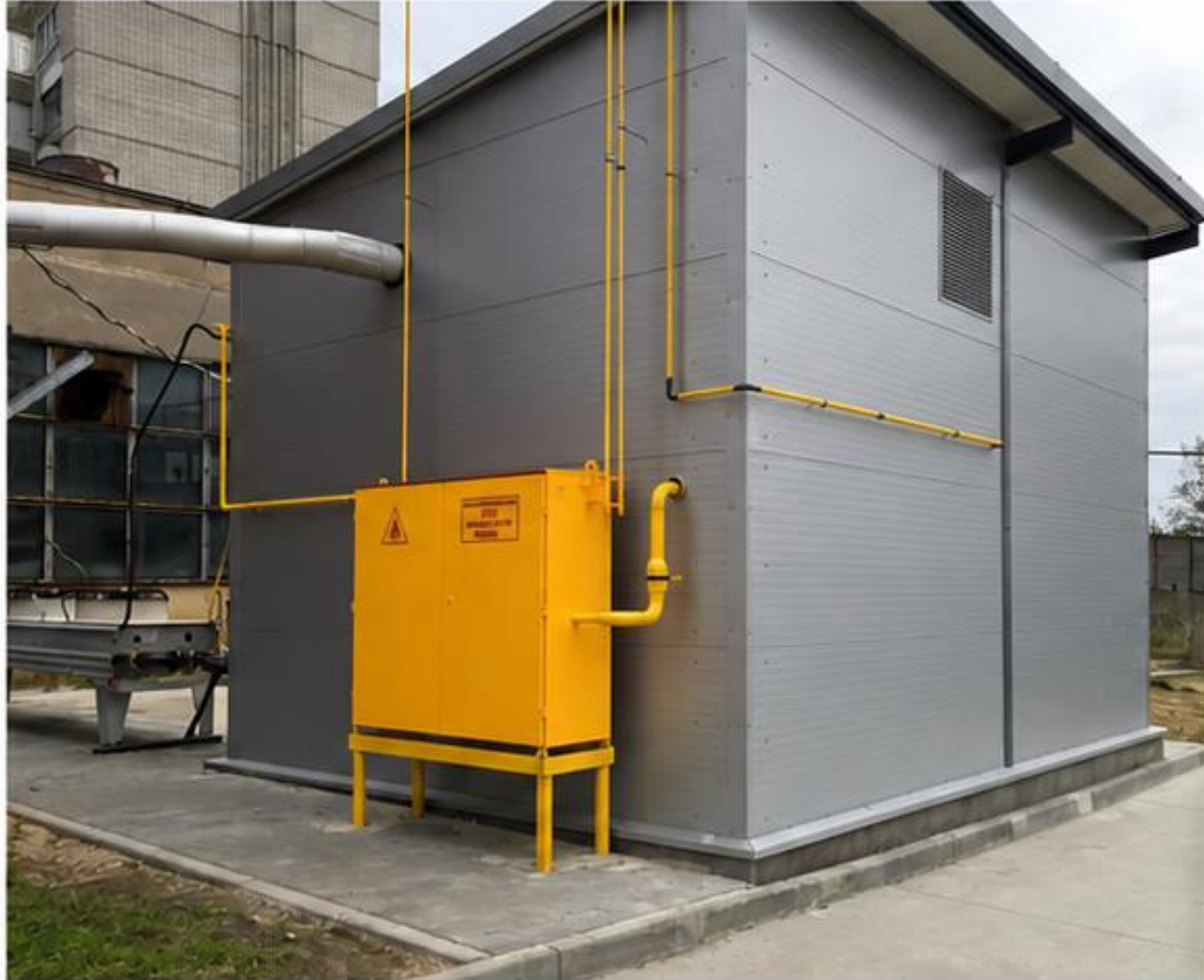
Будівля когенераційної установки (в кожусі)
