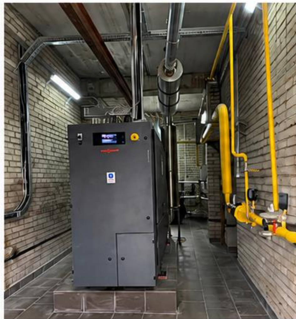
Когенераційна установка Viessmann (всередині приміщення)
