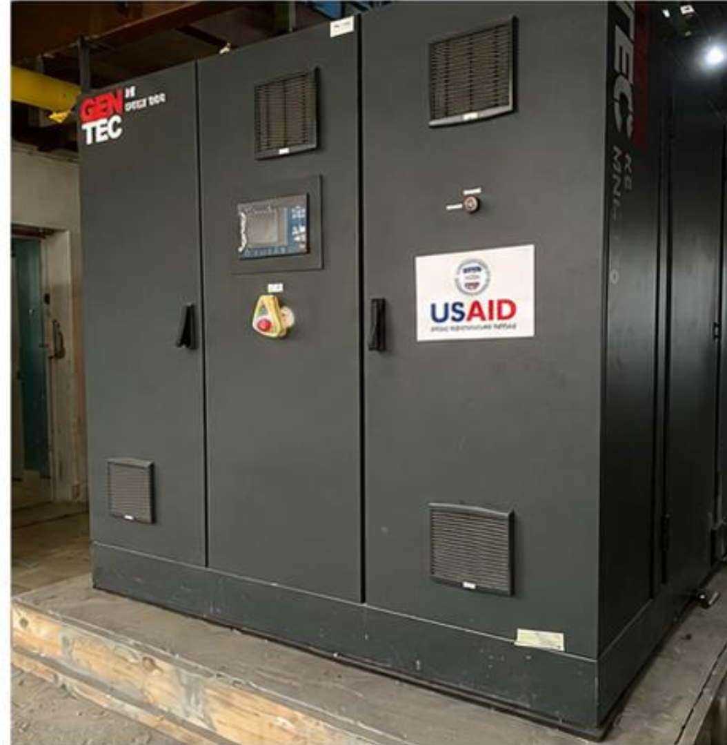
Когенераційна установка Gentec
