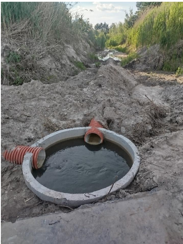
Рис. 1.8. Гідротехнічний колодязь на шляху руху зворотніх вод до р. Білка
